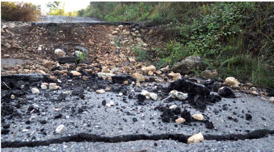
Une illustration des dégâts provoqués par les mouvements de terrain sur la route surplombant le hameau de Fonséry.
