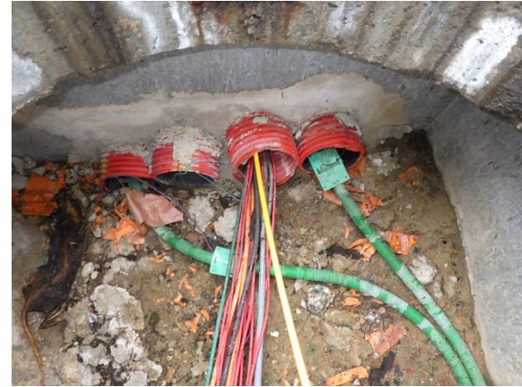
Vue des fourreaux dans la chambre FT
