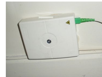
Point à Terminaison Optique
